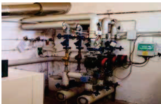
Immagine 2 Impianto con caldaia a basamento a condensazione © Termogestione.it
